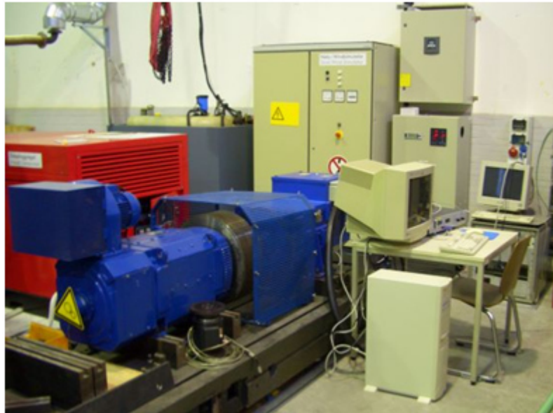
Abbildung 129: Der 80 kVA-Maschinensatz als Nachbildung einer Windenergieanlage
